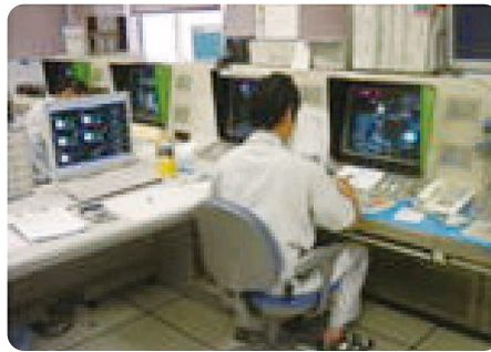
水処理設備監視システム
