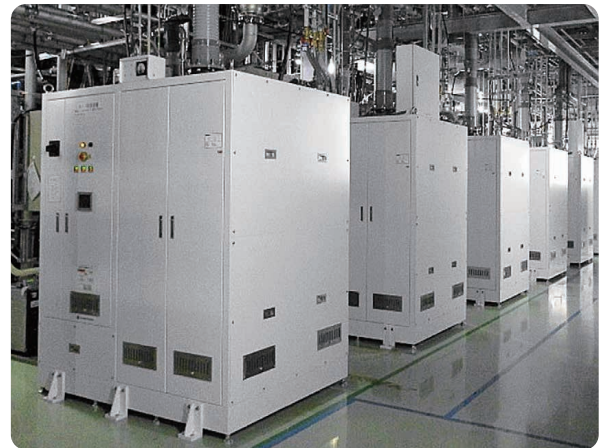
PFC等ガス除害装置
