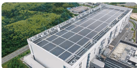
当工場第6製造棟に設置した太陽光発電システム
